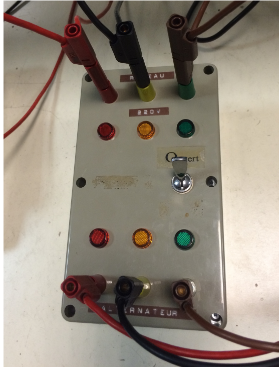
Interrupteur triphasé, juste avant couplage (lampes éteintes)
